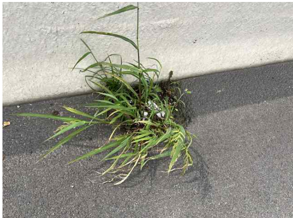
배수시설 S2 배수구 토사퇴적
