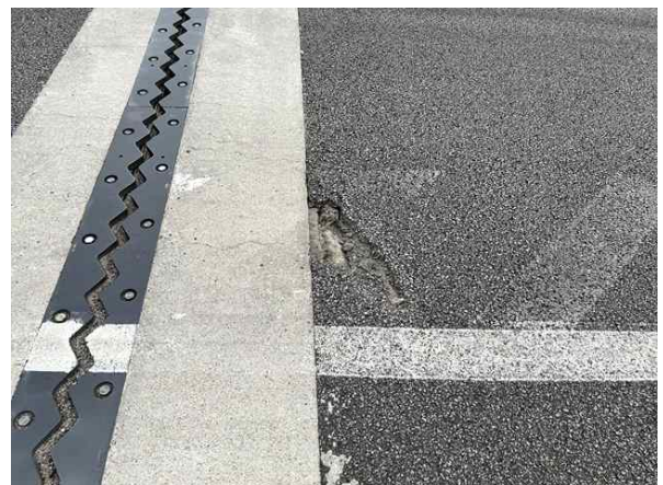
교면포장 S2 접속도로 아스콘 파손 (0.2×0.5)
