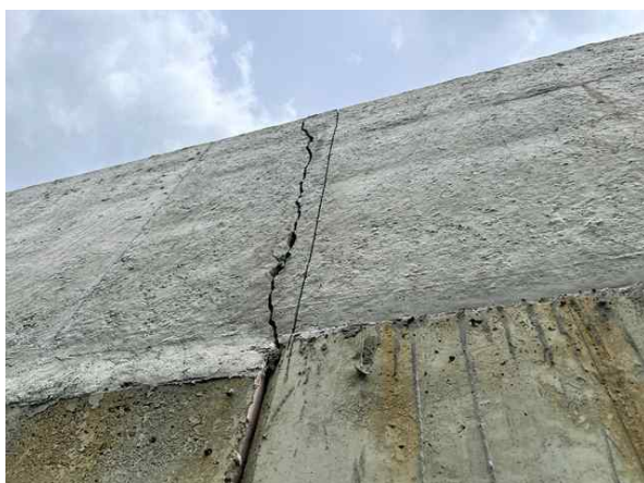
방호벽 S1 접속부 파손(0.1 × 1.5)
