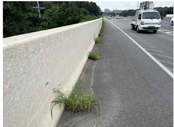
배수시설 S2 배수구 토사퇴적
