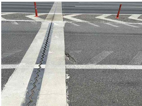
교면포장 S2 접속도로 아스콘 파손 (0.2×0.5)
