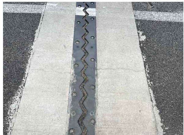
신축이음 A2 후타재 균열(Cw=0.3mm미만)
