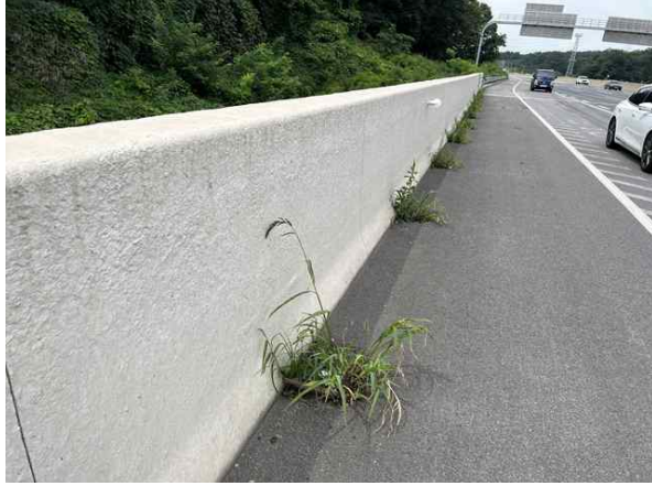
배수시설 S1 배수구 토사퇴적
