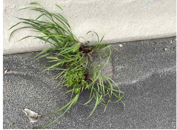
배수시설 S1 배수구 토사퇴적
